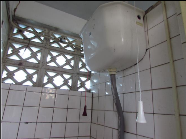
說明: 廁所沖水裝設兩段式沖水
